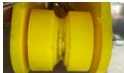
Slitasjeskade på hjulet fra vaieren
